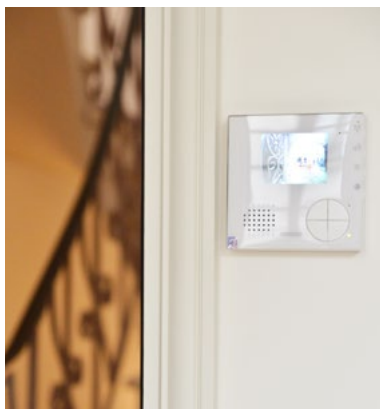
Accès sécurisé par visiophone
