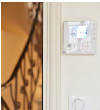
Accès sécurisé par visiophone
