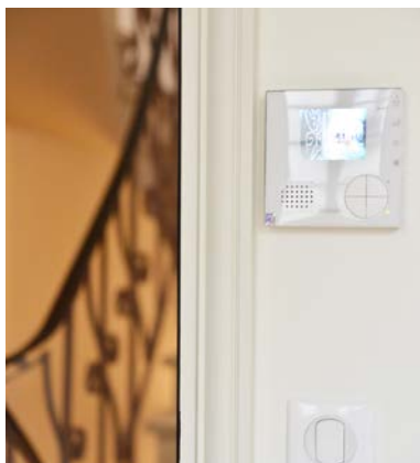
Accès sécurisé par visiophone
