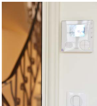
Accès sécurisé par visiophone
